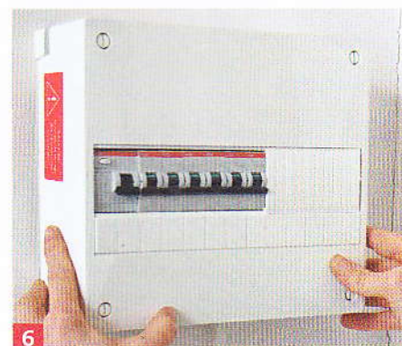
6 Refermez le tableau en vissant le capot. Prenez soin de repérer et de noter la fonction de chaque disjoncteur en collant des étiquettes sur la façade.
