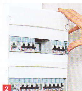
2 Le capot se visse ensuite très simplement sur la structure du tableau qui est fixée au mur.
